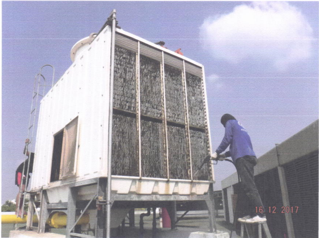
ภาพที่ 1 แสดงการล้างทำความสะอาด Cooling tower
