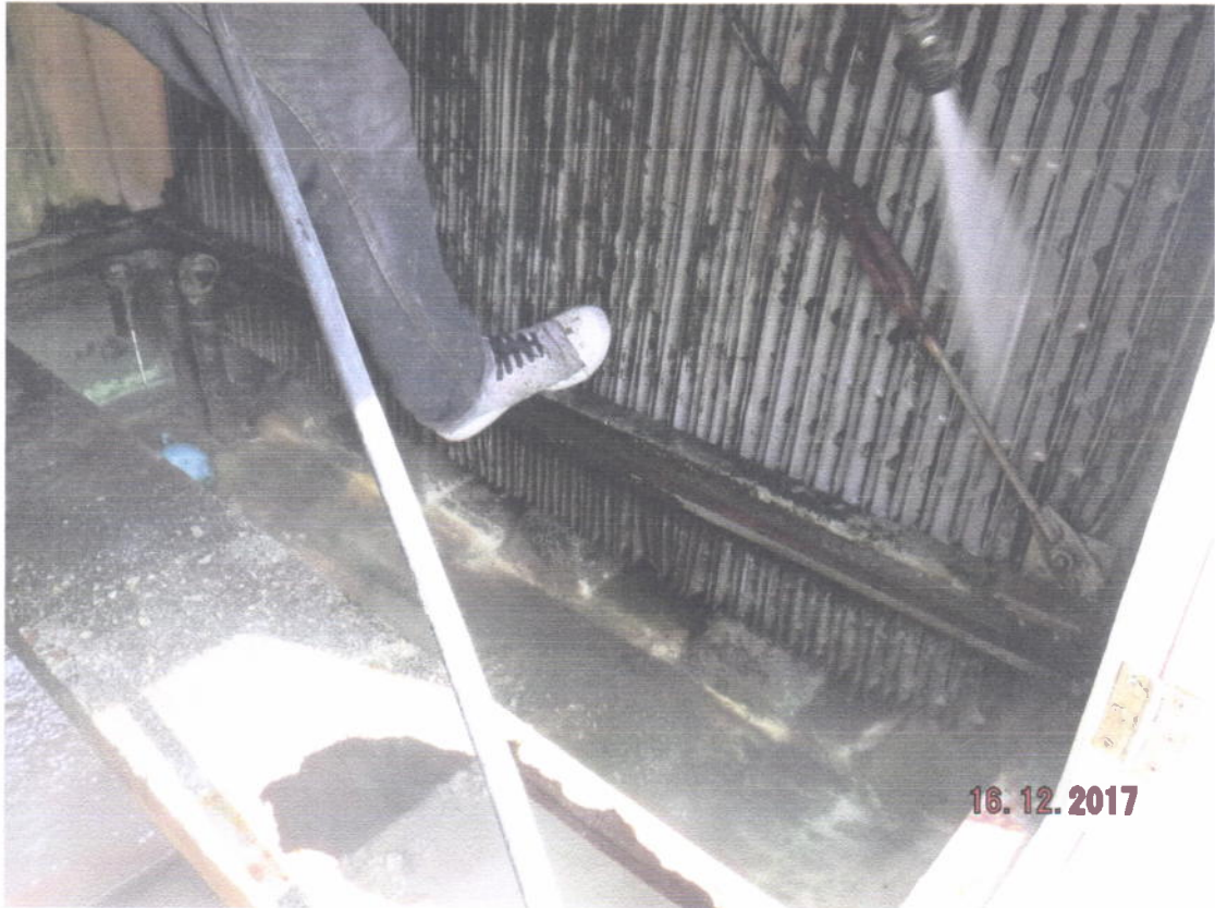
ภาพที่9 แสดงการล้างทำความสะอาด Cooling tower
