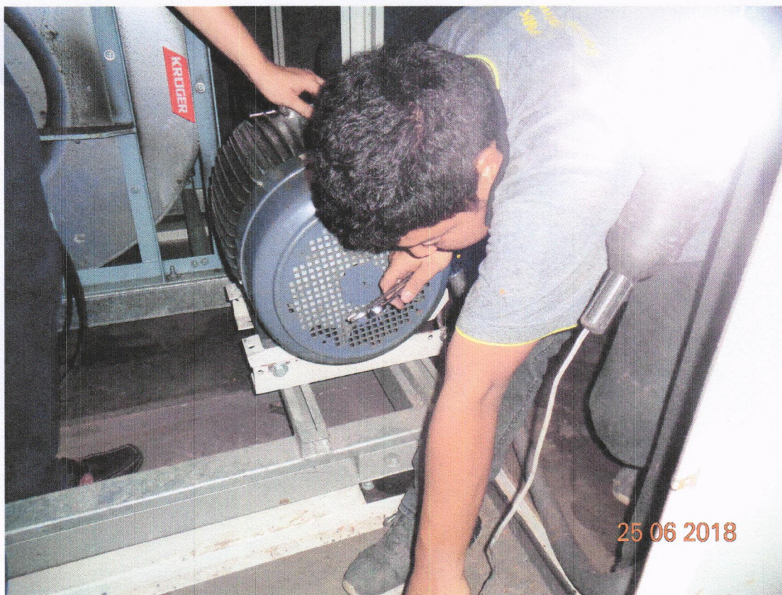
รูปที่ 13 นำมอเตอร์ ของ AHU -2B ที่นำไปซ่อมกลับมาติดตั้งให้ใช้งานได้ตามปกติ
