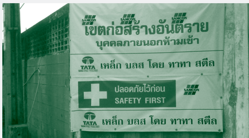
ภาพที่ 28 ทุกครั้งที่มีการก่อสร้างหรือต่อเติมอาคารจะต้องมีป้ายเตือนเสมอ
